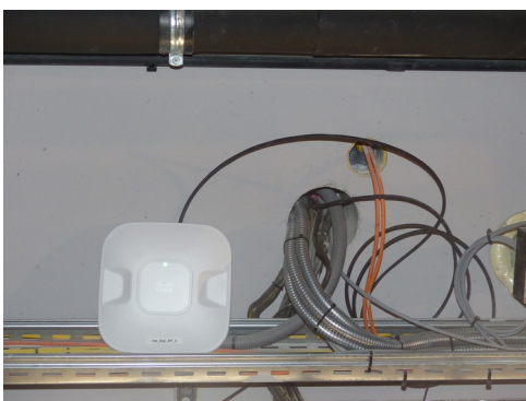
Figure 3: Borne Wi-Fi connectée directement sur le port interne du micro-commutateur le plus proche
