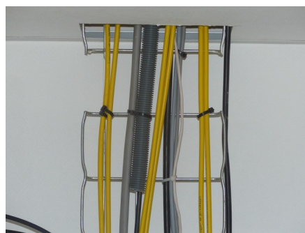
Figure 6: Répartiteur central au LEGI – 6 câbles de 72 fibres (3 boucles) – 432 ports LC, soit 864 terminaisons RJ45 potentielles en duplex (1728 en simplex)
